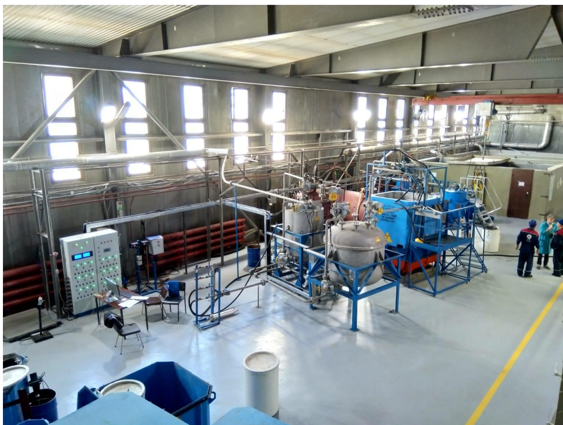
Рисунок 3 — Общий вид установки кондиционирования ОИОС
